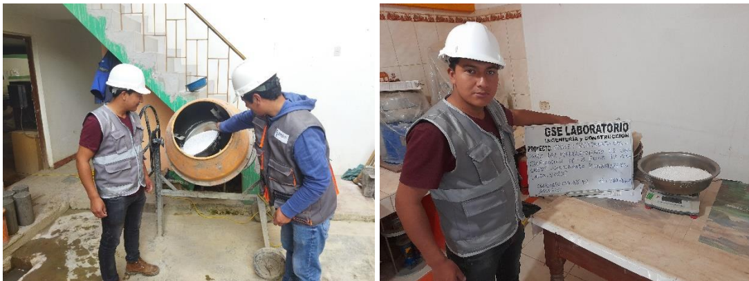
Fotografía 8: Preparación de probetas con los diferentes diseños de mezcla de propuestos, así mismo control de prueba de Slam y control de temperatura del concreto.
