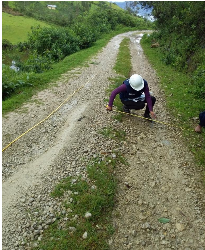
Fotografía 9. Tramos más incidentes por deformación
