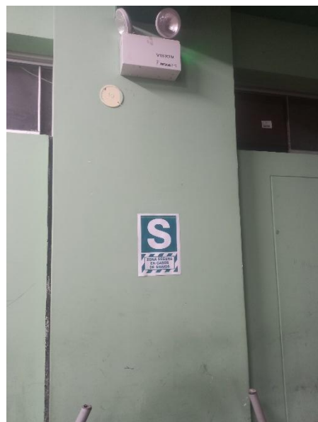
Pequeñas fisuras en columnas
