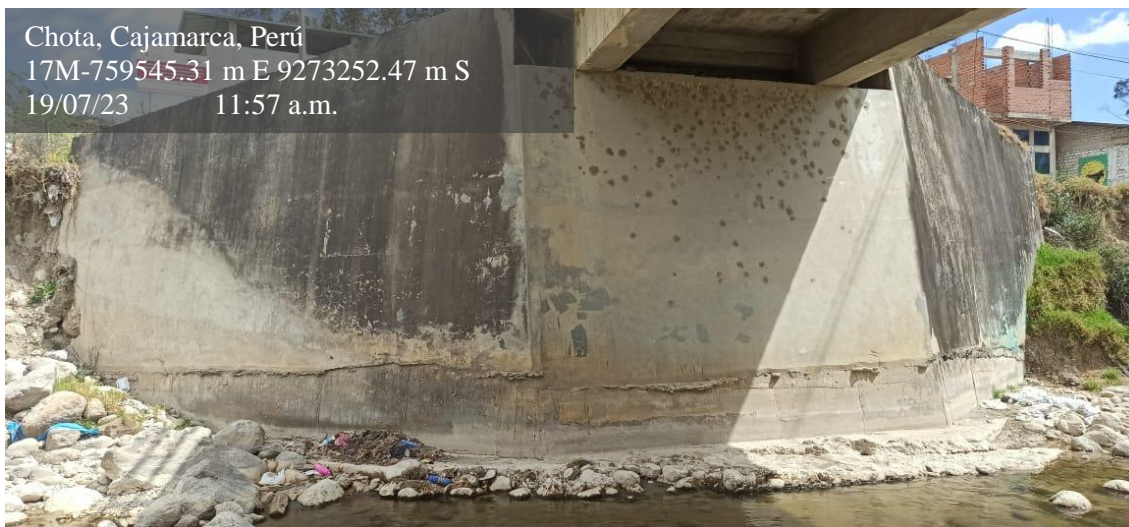
Fotografía 2: Presencia de socavación en el estribo izquierdo del puente Cementerio
