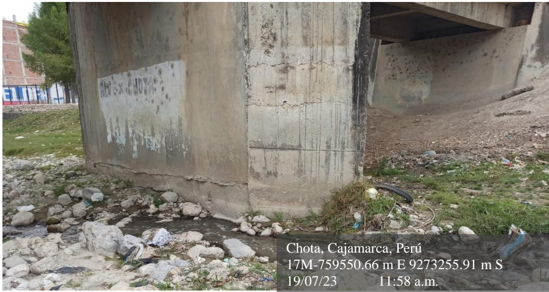
Fotografía 3: Presencia de socavación en el pilar del puente Cementerio
