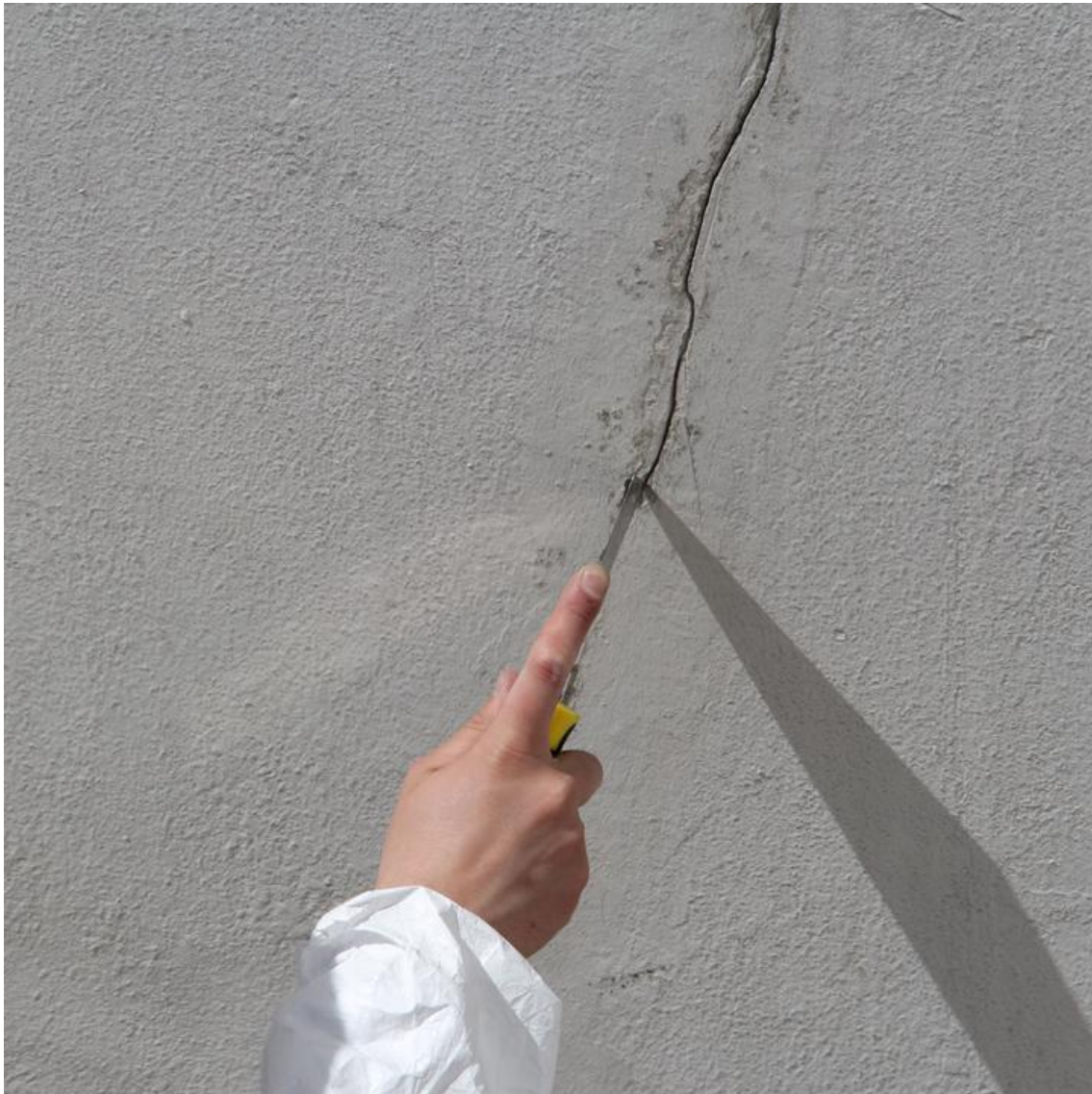
Fotografía 3: Grietas en los elementos estructurales de la I.E.S. Comercio
