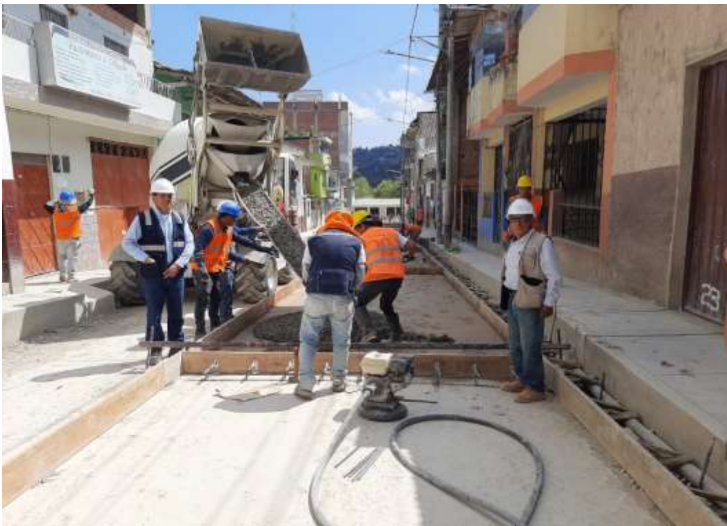
Fotografía 28. Colocación de concreto f'_c=210 \text{ kg/cm}^2 para pavimento rígido e=0.20 \text{ m}
