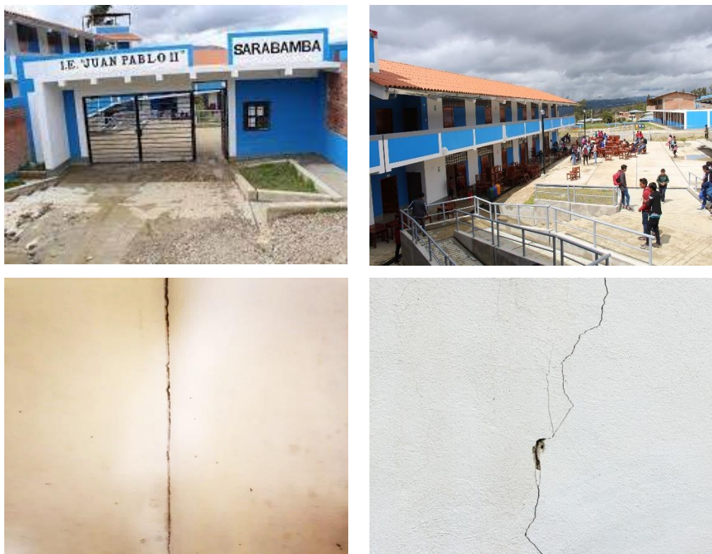
Colegio Juan Pablo II de Sarabamba y Vista de Algunas Grietas y Fisuras en sus Componentes Estructurales
