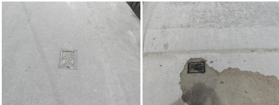
Fotografía N° 20: Válvulas de compuertas (la primera operativa y la segunda averiada).
