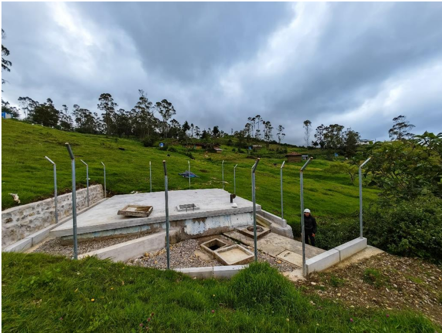
Fotografía N° 04: Captación las Zarzas.
