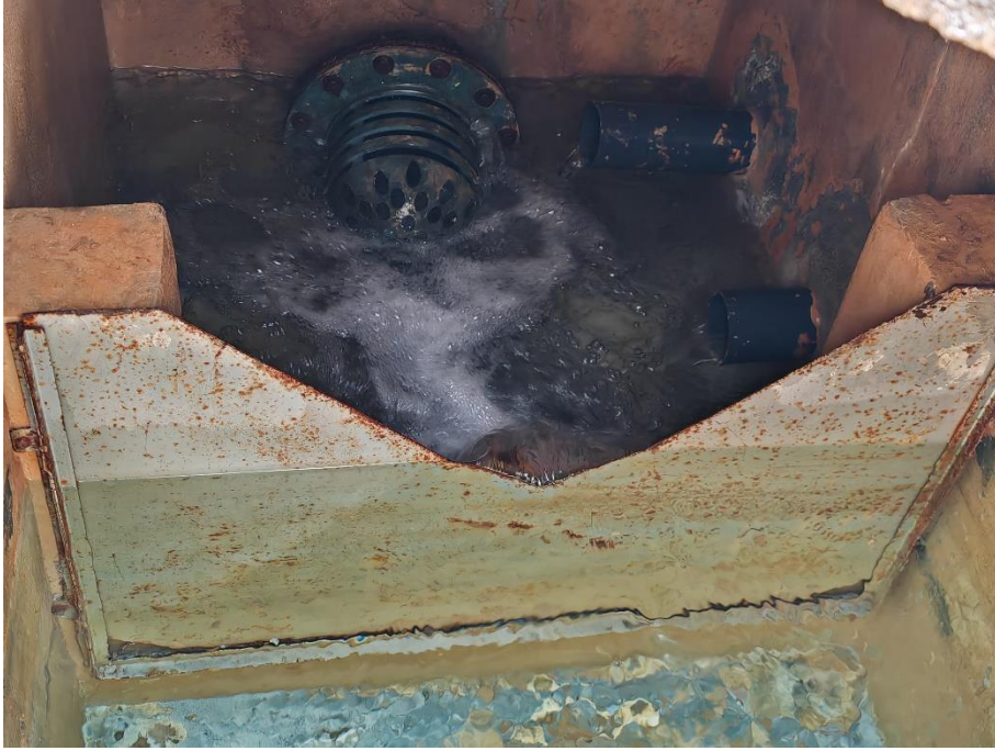
Fotografía N° 03: Cámara repartidora de caudales el Suro.
