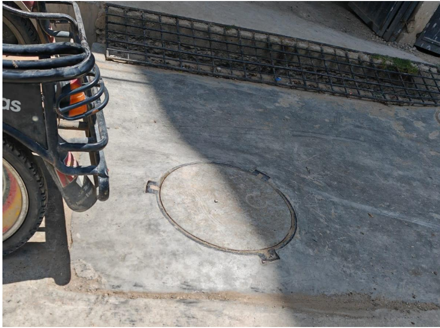
Fotografía N° 19: Válvula reductora de presión N° 9.
