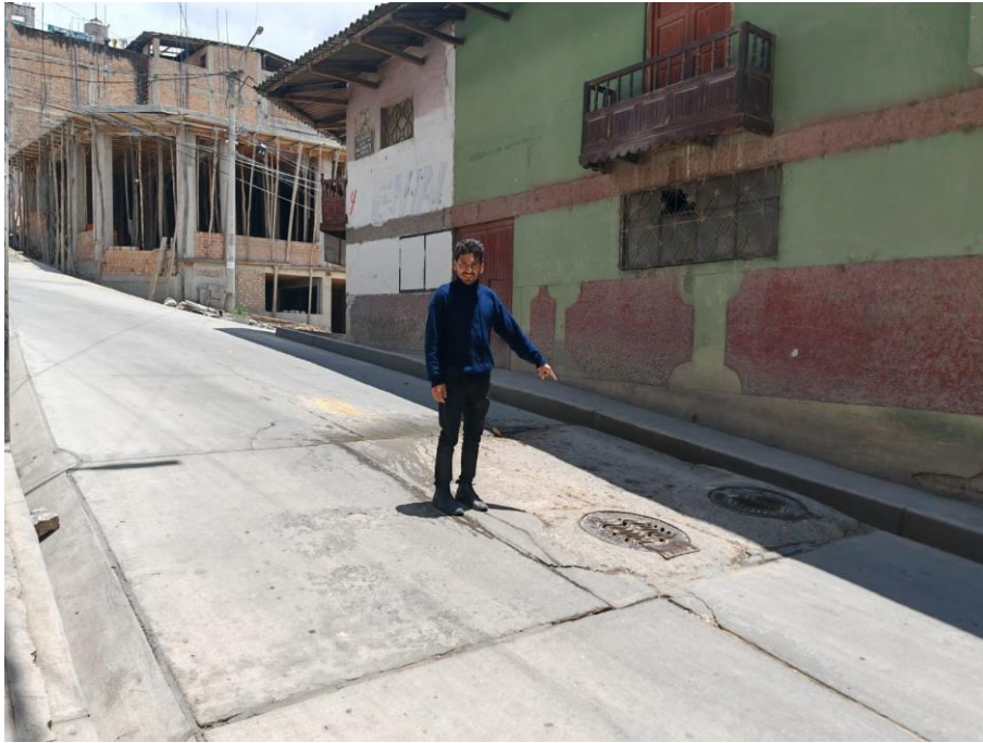
Fotografía N° 15: Válvula reductora de presión N° 5.
