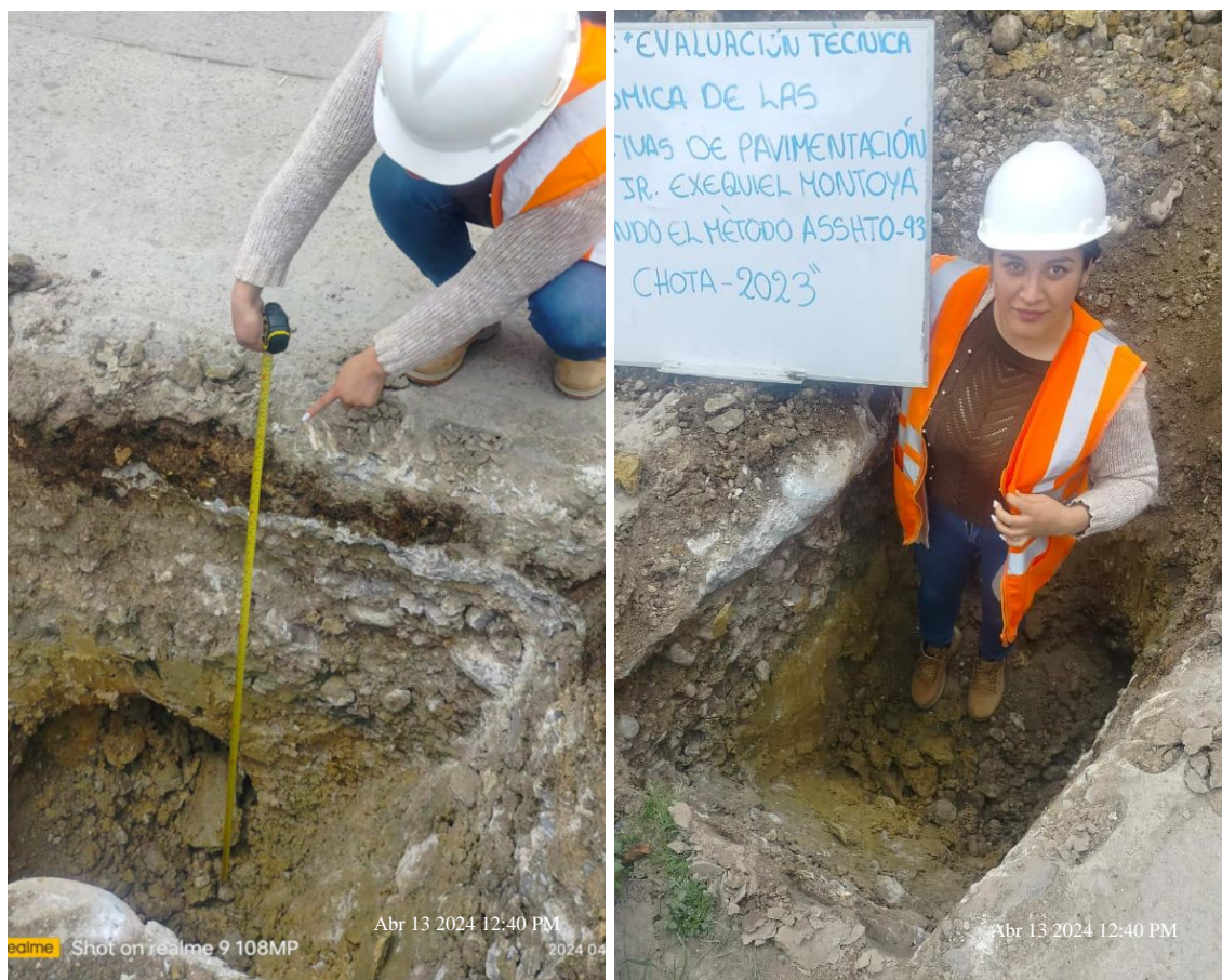
Fotografía 9. Recolección de Muestras de Suelo en las Calicatas en el Jr. Exequiel Montoya
