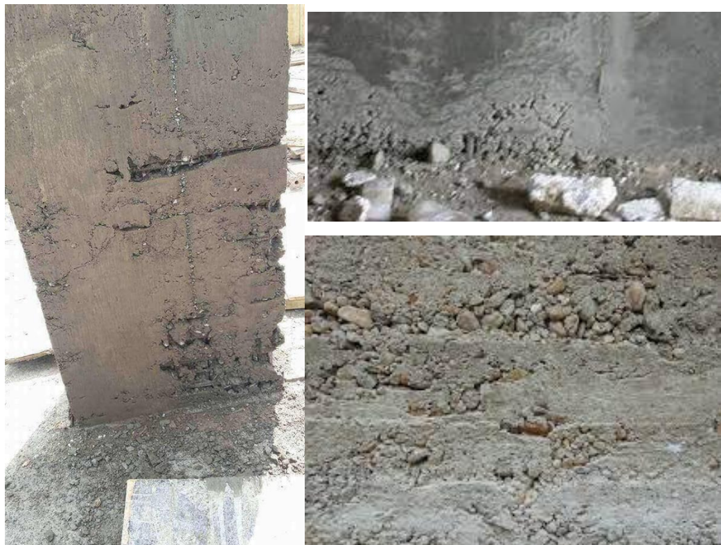
Segregación en Elementos Estructurales de Edificaciones Locales
