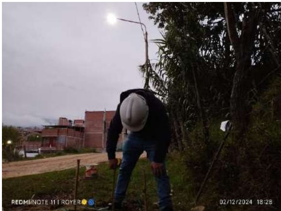
Foto N ° 27. Medición de altura de infiltración.
