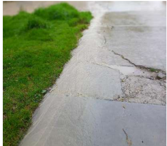
Foto N ° 02. Deterioró del Pavimento debido a la falta de cunetas.
