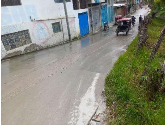
Foto N ° 01. Aguas de escurrimiento drenan por la calle por falta de cunetas.
