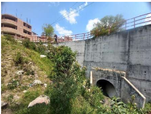
Foto N ° 05. Punto de descarga de drenaje Jr. San Juan - Sector 4
