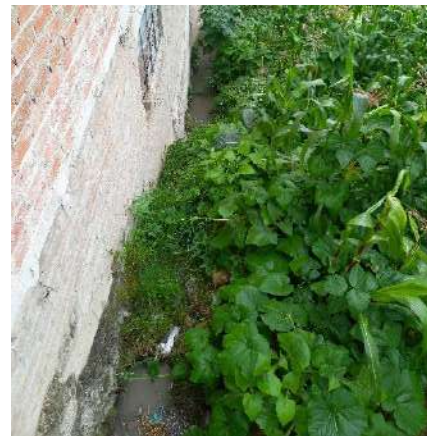
Foto N ° 06. Punto de descarga de drenaje Jr. 30 de Agosto - Sector 4.
