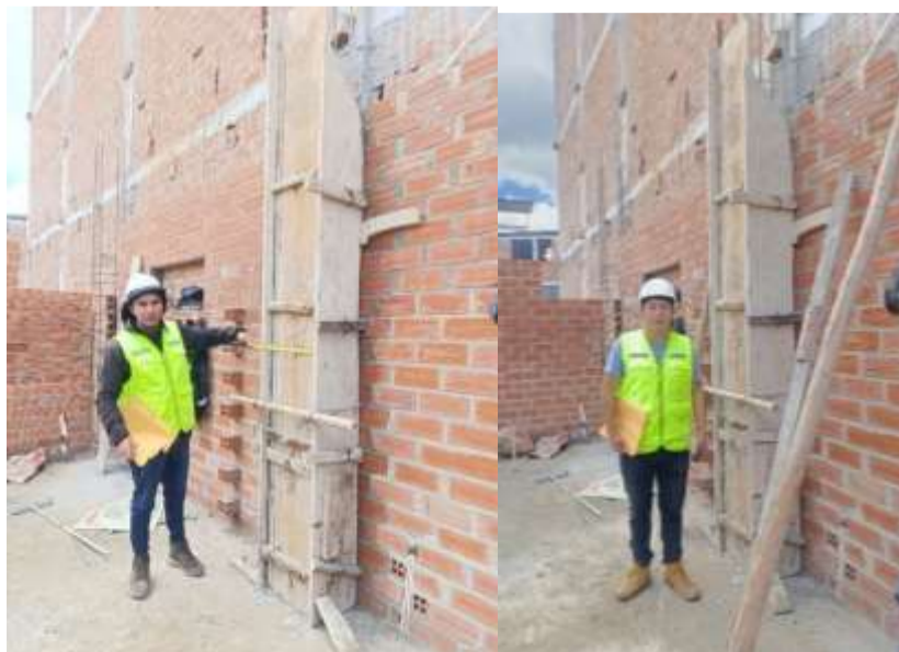
Fotografía 23. Medición del rendimiento en el encofrado de columnas de la vivienda N° 6
