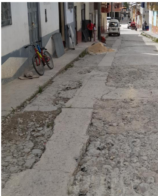
Fotografía 189. Vista del mal estado de las calles a causa de la ausencia de un adecuado sistema de drenaje pluvial en la ciudad de Lajas
