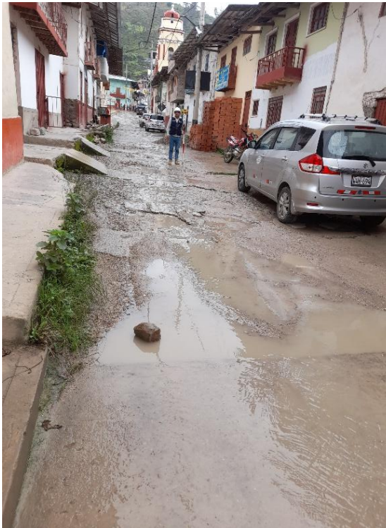
Fotografía 17. Vista del mal estado de las calles a causa de la ausencia de un adecuado sistema de drenaje pluvial en la ciudad de Lajas
