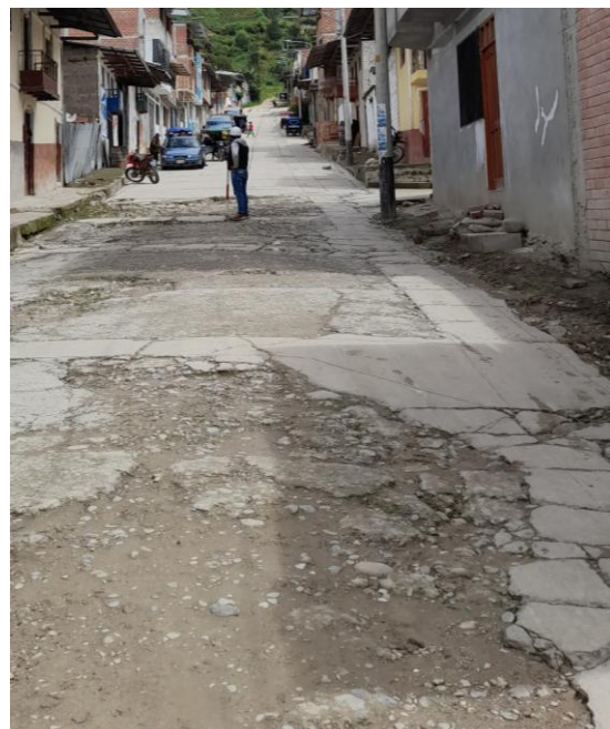
Fotografía 20. Vista del mal estado de las calles a causa de la ausencia de un adecuado sistema de drenaje pluvial en la ciudad de Lajas
