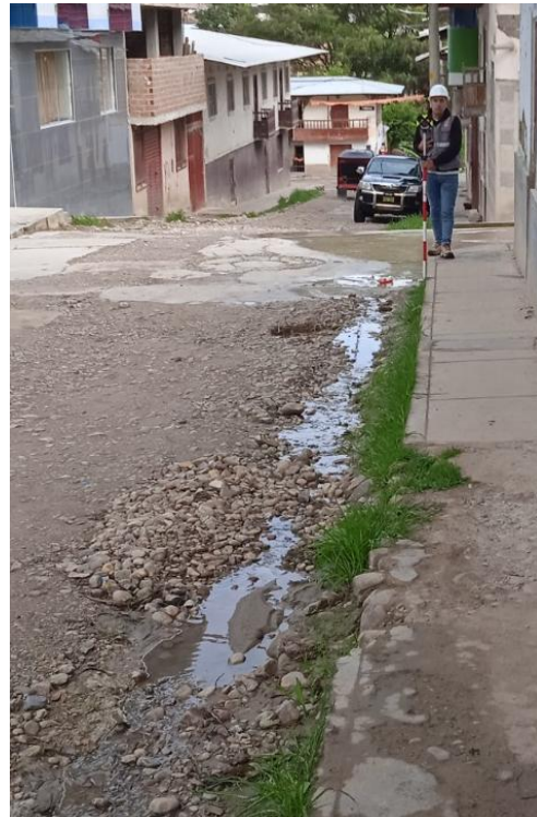
Fotografía 19. Vista del mal estado de las calles a causa de la ausencia de un adecuado sistema de drenaje pluvial en la ciudad de Lajas
