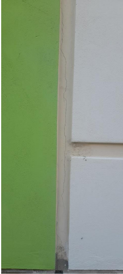
Vista de fisuras alrededor de las columnas del módulo 2
