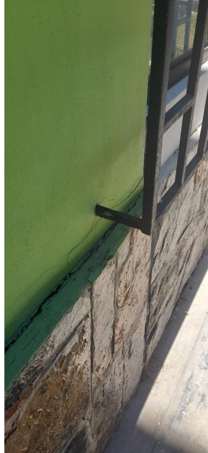
Vista de grietas sobre el zocálo colocado en la parte posterior del módulo 3
