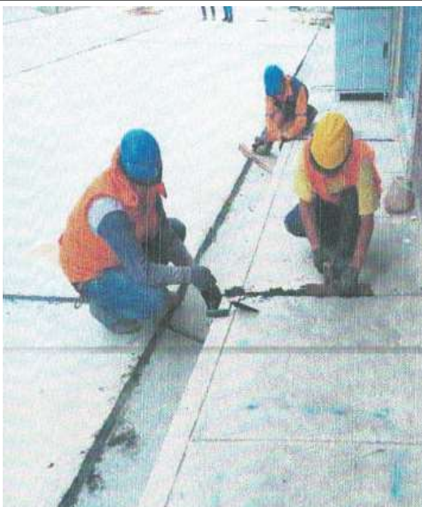
FOTOGRAFÍA N° 34: llenado de juntas en veredas e=1'' haciendo uso de asfalto liquido RC-250
