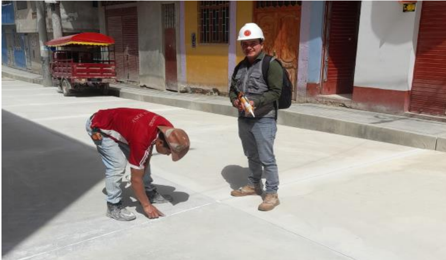
FOTOGRAFÍA N° 22: Llenado de juntas de dilatación haciendo uso de Sikaflex Selladores de juntas.
