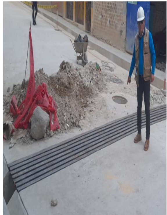
FOTOGRAFÍA N° 25: rejilla metálica para alcantarilla
