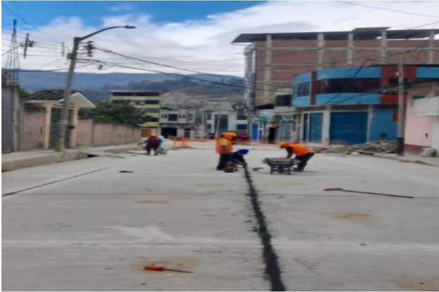
FOTOGRAFÍA N° 28: llenado de juntas en pavimento e=1” haciendo uso de asfalto liquido RC-250
