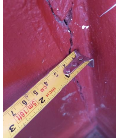
Fisuras en juntas de tabiques
