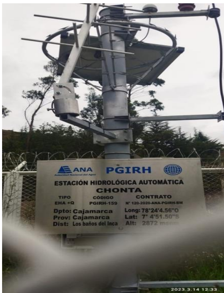
Fotografía 31 Sistema de sensores de Estación Hidrológica Automática Chonta.
