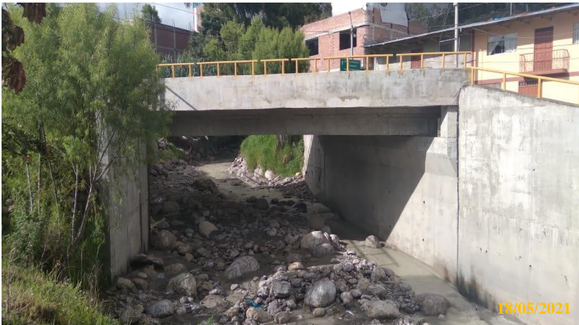
Fotografía 2. Vista del puente Colpamayo ubicado en el Jr. Sagrado Corazón de Jesús
