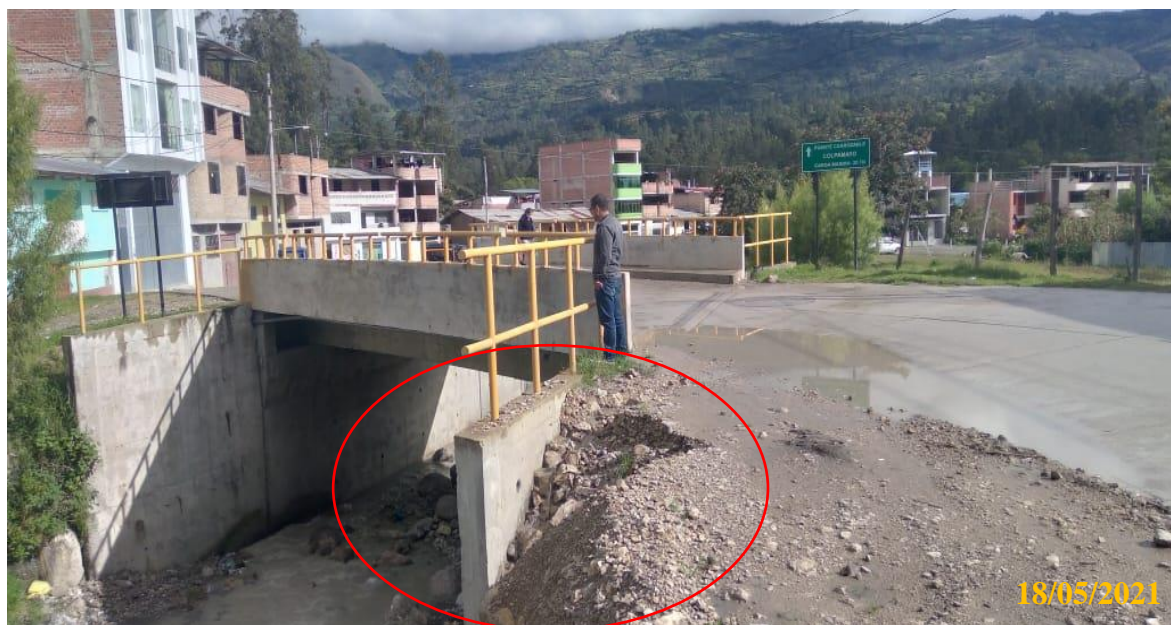
Fotografía 3. Vista de desprendimiento lateral de tierra en el puente Colpamayo ubicado en el Jr. Sagrado Corazón de Jesús
