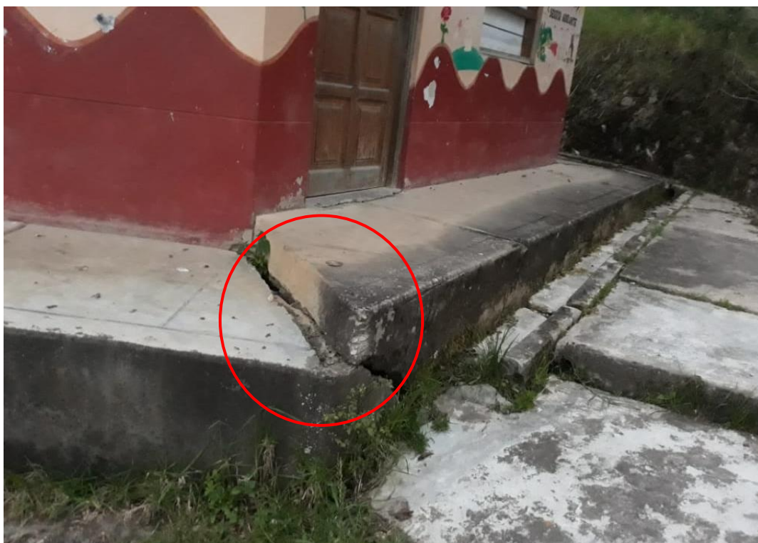
Figura 63 Asentamiento de las Veredas
