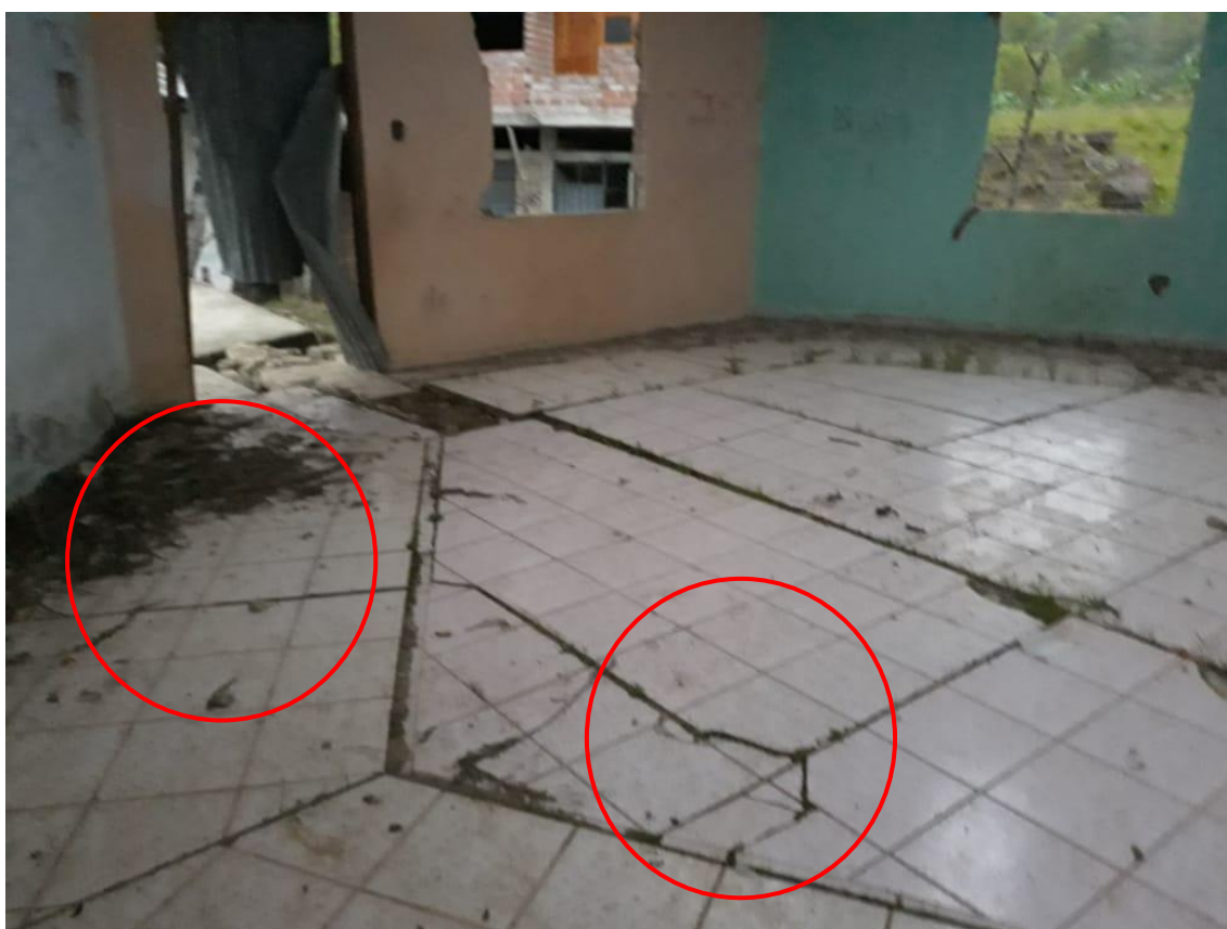
Fisuras en los Pisos de la I.E. 10392
