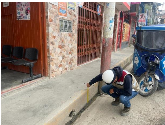
FOTO N° 15: VERIFICACIÓN DE CUNETAS EXISTENTES EN MAL ESTADO.
