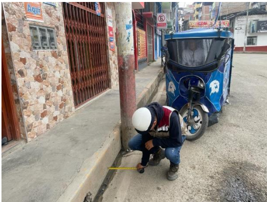
FOTO N° 14: VERIFICACIÓN DE CUNETAS EXISTENTES EN MAL ESTADO.
