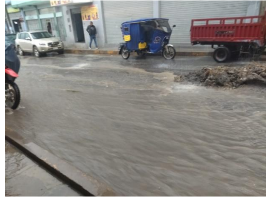
FOTO N° 28: POR FALTA DE CUNETAS LAS AGUAS DE ESCURRIMIENTO DRENAN POR LAS CALLES EN EL JR. OSORES.
