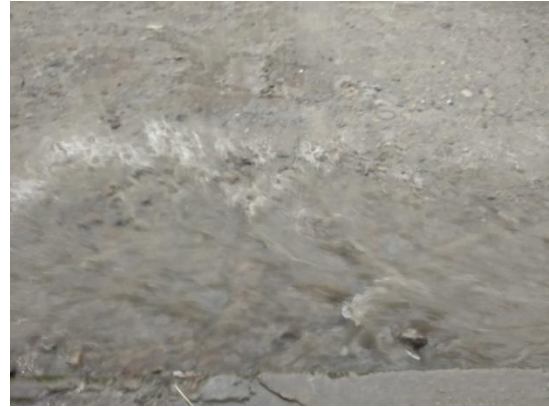
FOTO N° 34: FALTA DE CUNETAS EN EL SECTOR 2.
