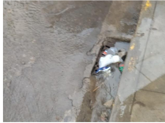
FOTO N° 40: FALTA DE MANTENIMIENTO DE LAS ESTRUCTURAS EXISTENTES DE DRENAJE PLUVIAL.
