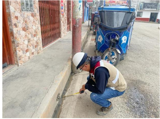
FOTO N° 16: VERIFICACIÓN DE CUNETAS EXISTENTES EN MAL ESTADO.
