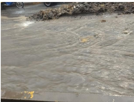
FOTO N° 26: POR FALTA DE CUNETAS LAS AGUAS DE ESCURRIMIENTO DRENAN POR LAS CALLES.
