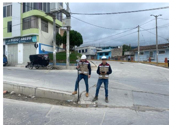
FOTO N° 12: L.T AV. INCA GARCILAZO DE LA VEGA (PARQUE EL RONDERO)
