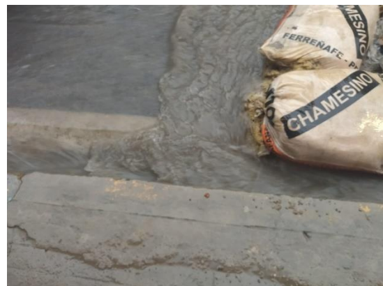
FOTO N° 29: CUENTAS TRIANGULARES NO APTAS PARA EL CAUDAL DE ESCURRIMIENTO EN EL SECTOR 2.
