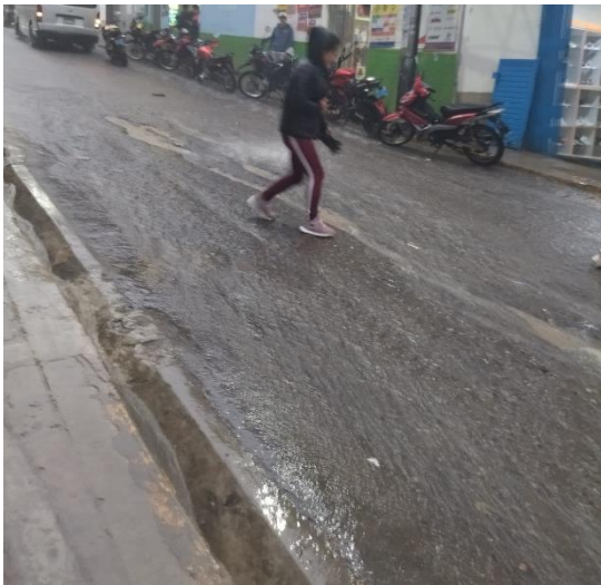
FOTO N° 32: POR FALTA DE CUNETAS OPTIMAS LAS AGUAS ESCURREN POR LA CALZADA IMPIDIENDO EL TRANSITO PEATONAL.
