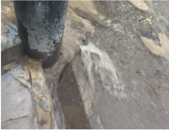
FOTO N° 31: CUNETAS NO APTAS PARA LA ZONA POR FUERTES LLUVIAS.
