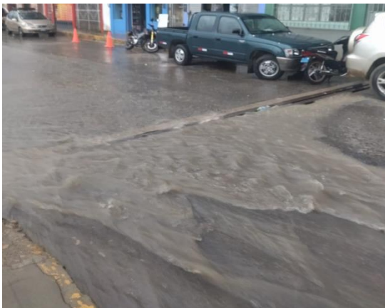
FOTO N° 27: POR FALTA DE CUNETAS LAS AGUAS DE ESCURRIMIENTO DRENAN POR LAS CALLES EN EL JR. OSORES.
