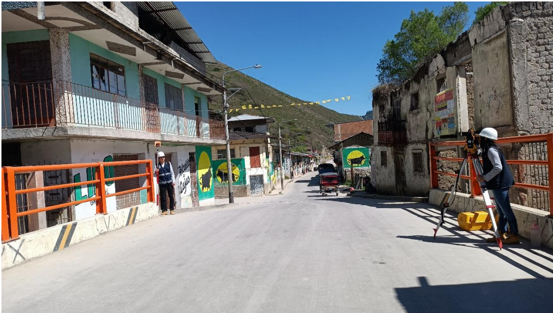
Fotografía 25. Rio Jalqueño: km 0+460 hasta km 0+220. Margen izquierdo: Presenta concreto sin terminar y los valores de 0.014.
