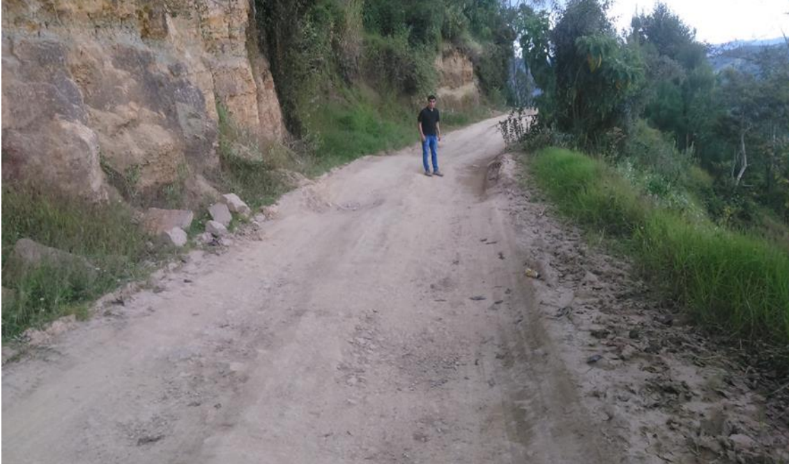
Fotografía 3. Ahuellamiento y hundimiento de la subrasante de la carretera El Verde – Numbral, Km 1+500 al Km 2+500
