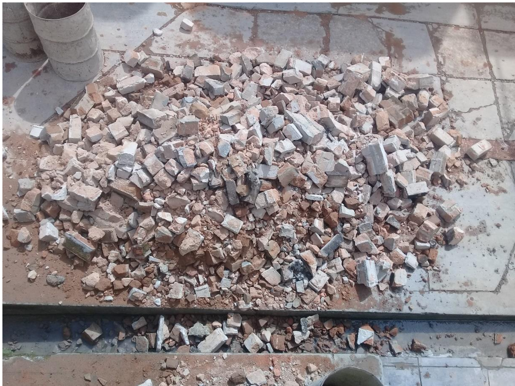
Escombros de Mortero y Ladrillo
