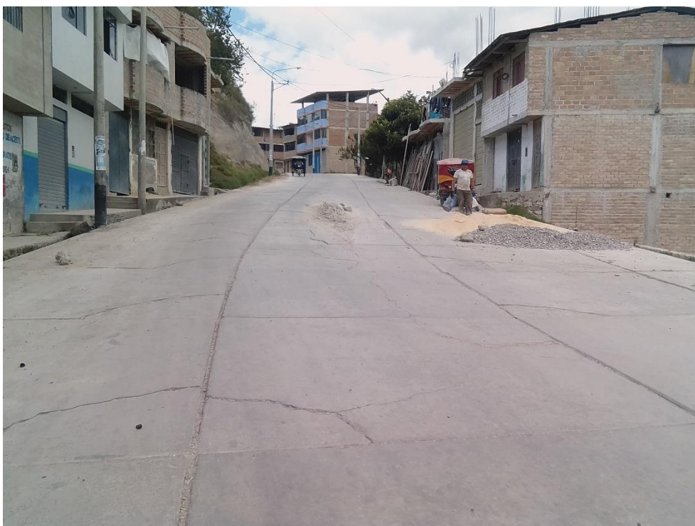
Fotografía 1. Presencia de fallas en la Av. Micaela Bastidas
